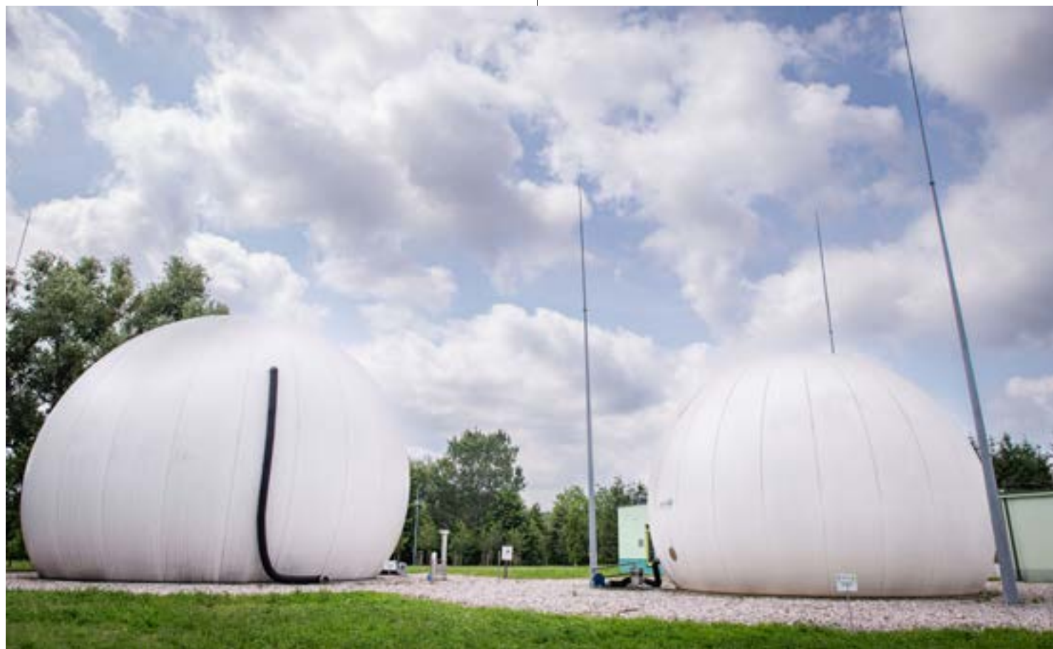
Zbiorniki biogazu, fot. Jacek Turczyk Biogas tanks, photo by Jacek Turczyk
