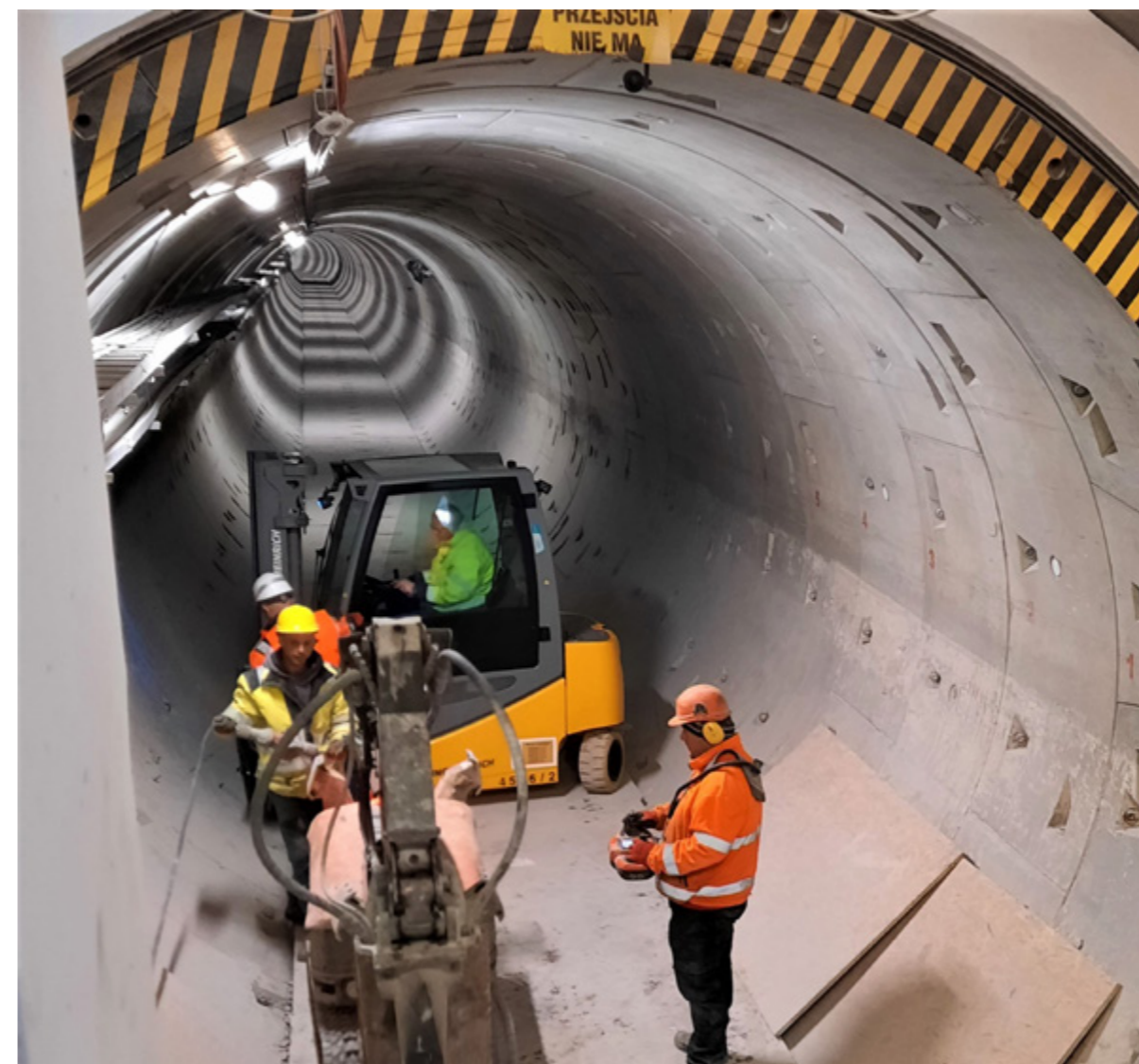
Budowa układu przesyłowego łączącego Zakład „Świderska” i Zakład „Farysa”, fot. archiwum MPWiK
