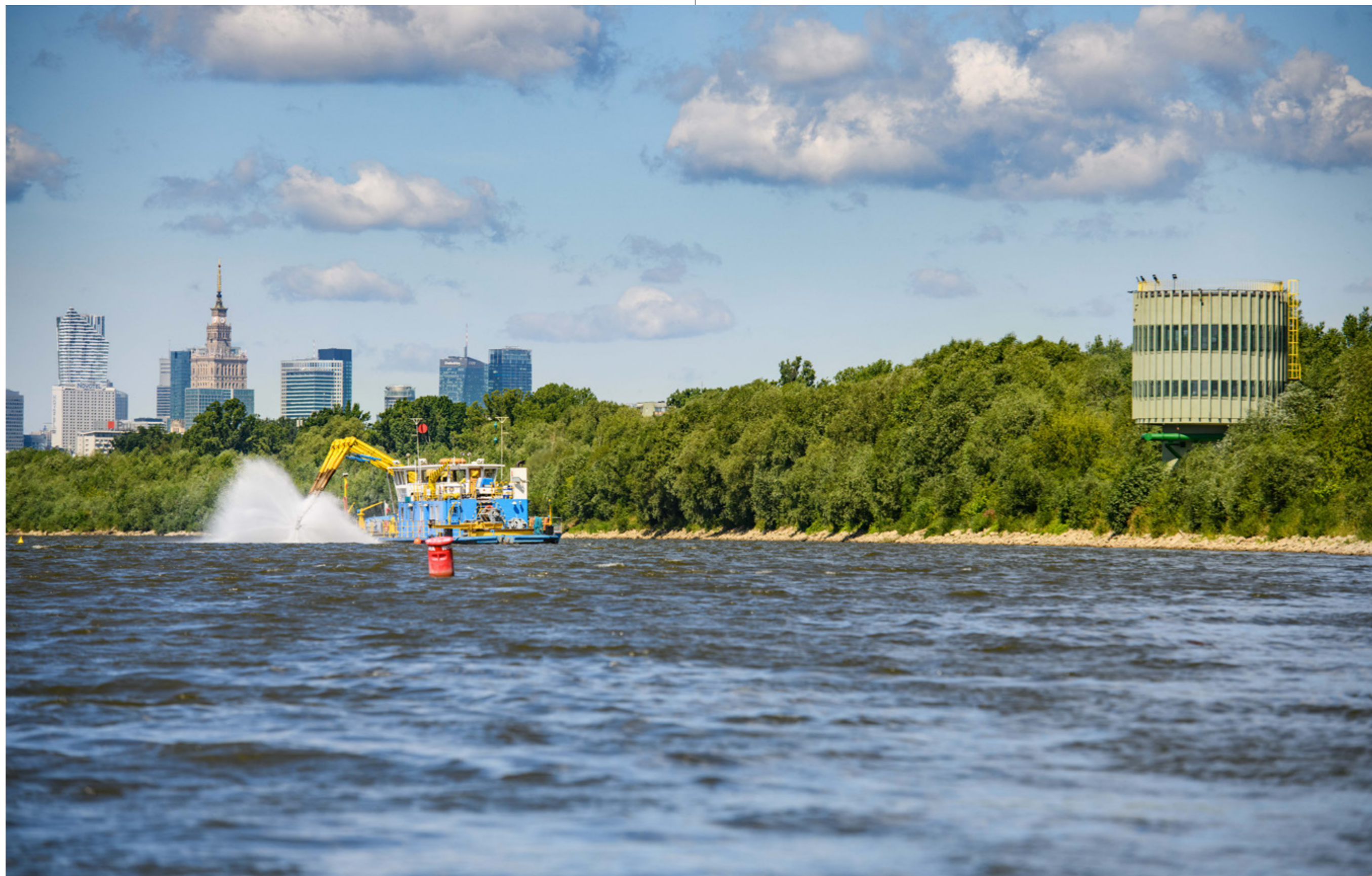
Spulchniacze hydrauliczne „Chude Wojtki”, nazwane tak na cześć ich twórcy inżyniera Jerzego Wojtkowskiego, to specjalistyczne statki. Ich zadaniem jest płukanie dna rzeki wodą pod ciśnieniem, aby usunąć wierzchnią, najbardziej zanieczyszczoną warstwę piachu. Na zdjęciu widać jednego z „Wojtków” podczas pracy na Wiśle, fot. Jacek Turczyk
