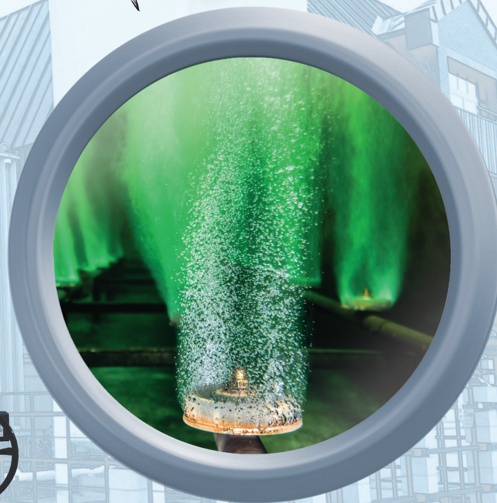
Wnętrze komory ozonowania. Fot. K. Kobus
