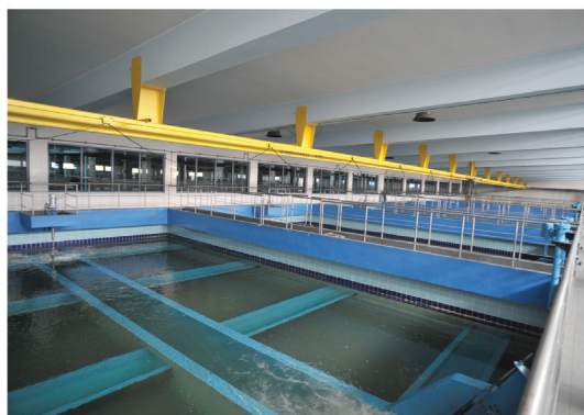
Filtry pospieszne w budynku pulsatorów. Fot. archiwum MPWiK
