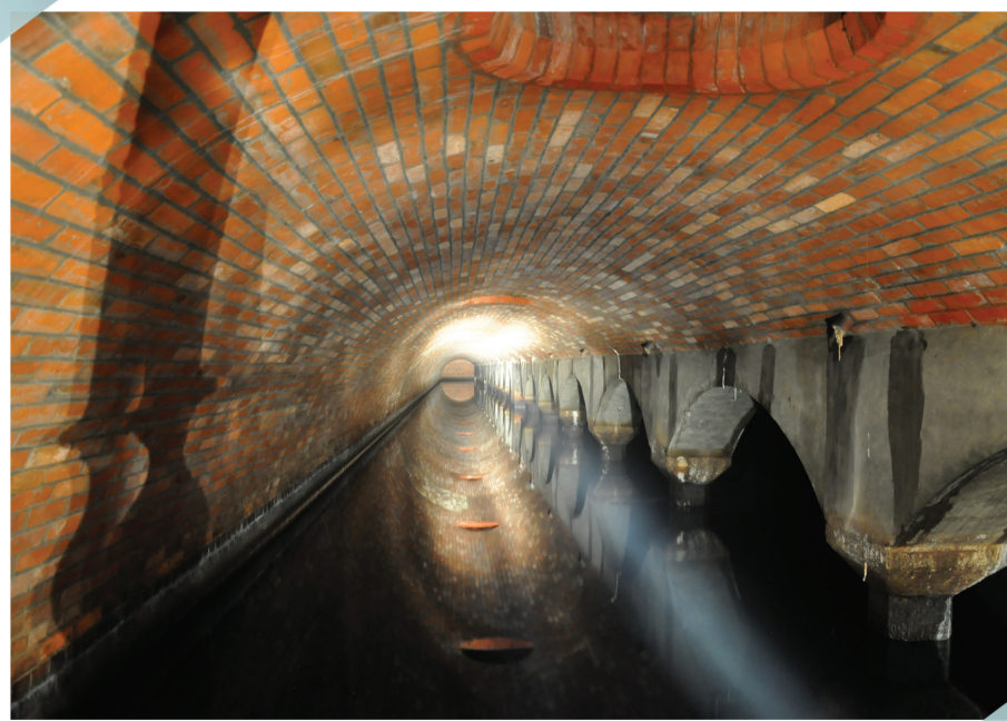
Osadnik wody surowej. Fot. W. Bliźniak
