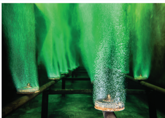
Wnętrze komory ozonowania. Fot. K. Kobus
