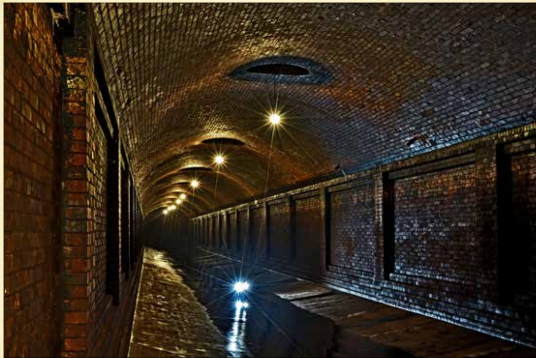
osadniki wody surowej
